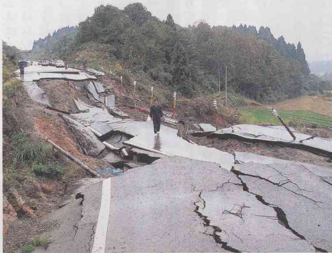
▲地震発生直後の小千谷市近郊の道路
